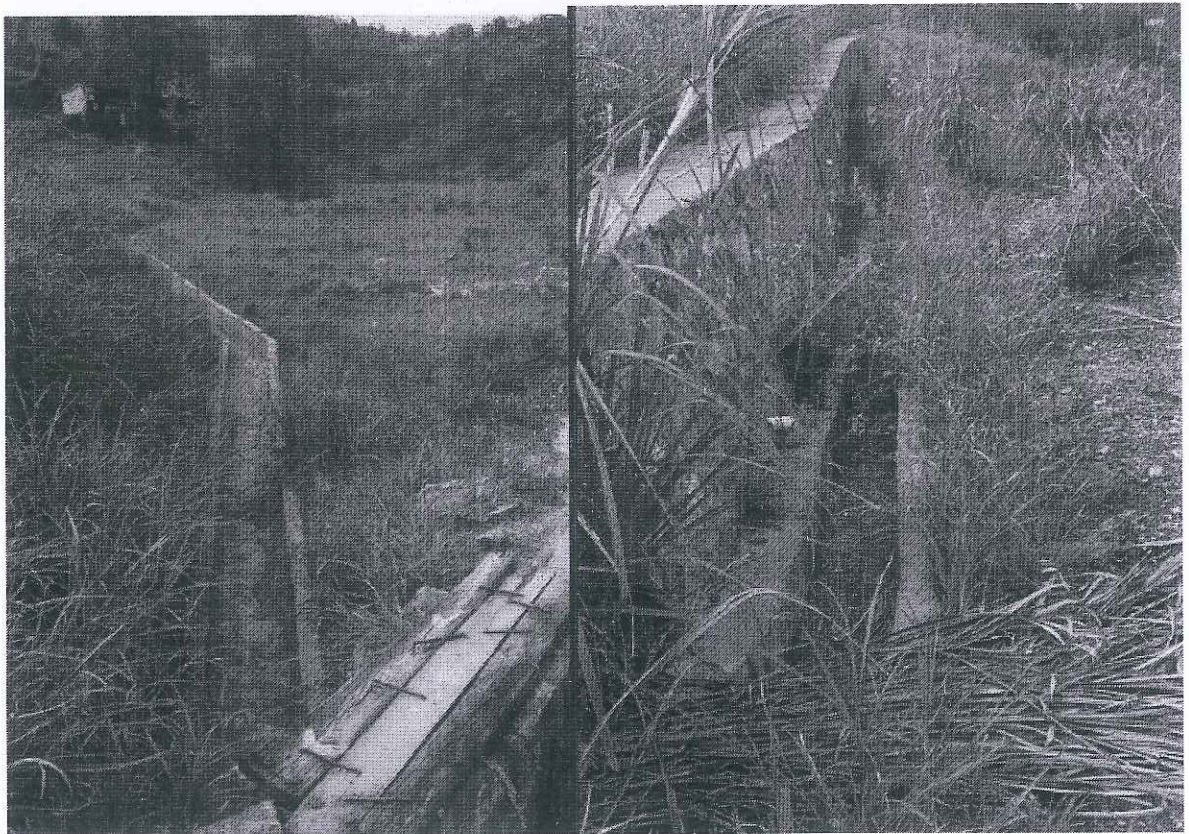
图 3.1-10 尾矿库排渗设施
